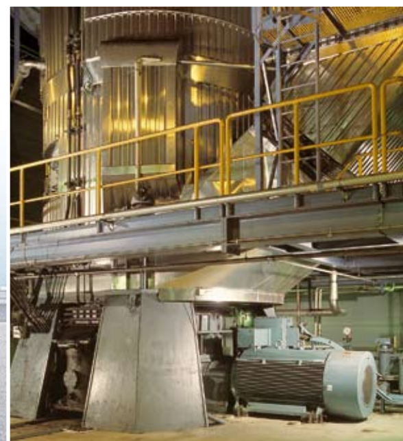
Электростанция Meri-Pori, двигатель угольной мельницы
